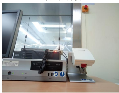
操作台及控制室内紧急止动按钮
