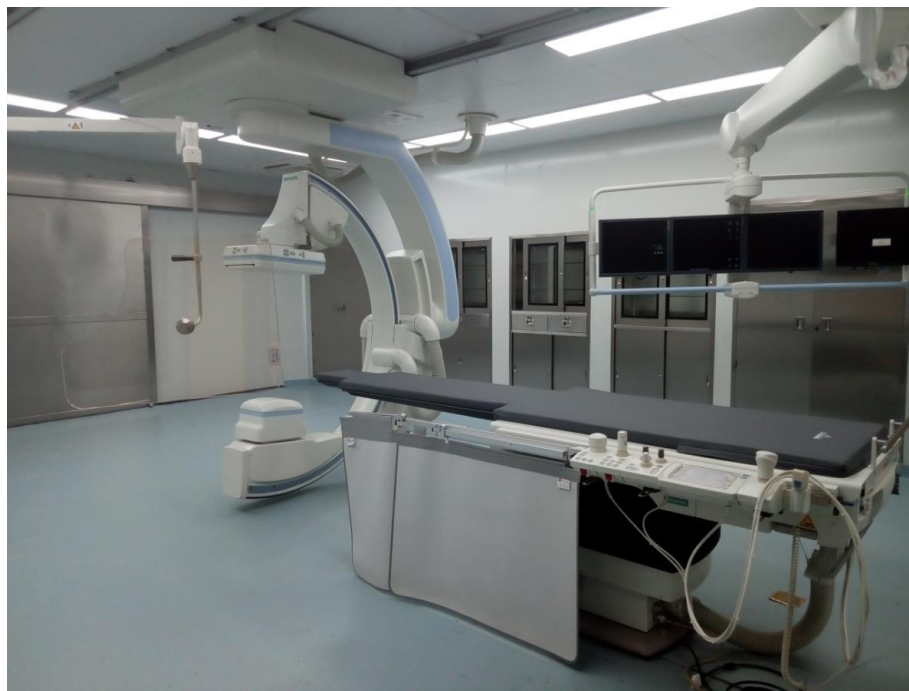
机房内设备全景图
